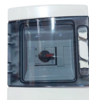
DC ochranná jednotka
